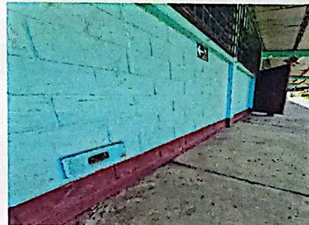
Foto 6: paredes de exteriores en mal estado modulos I, II Y III
